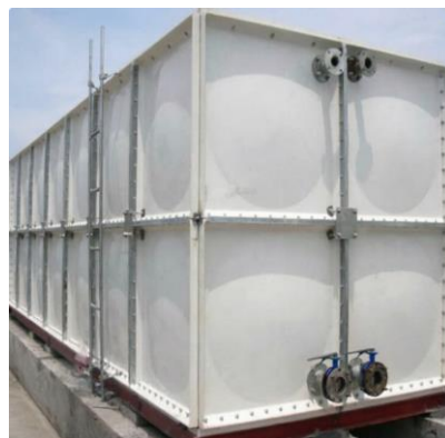
배관이 설치된 물탱크 Finished water tank with pipes
